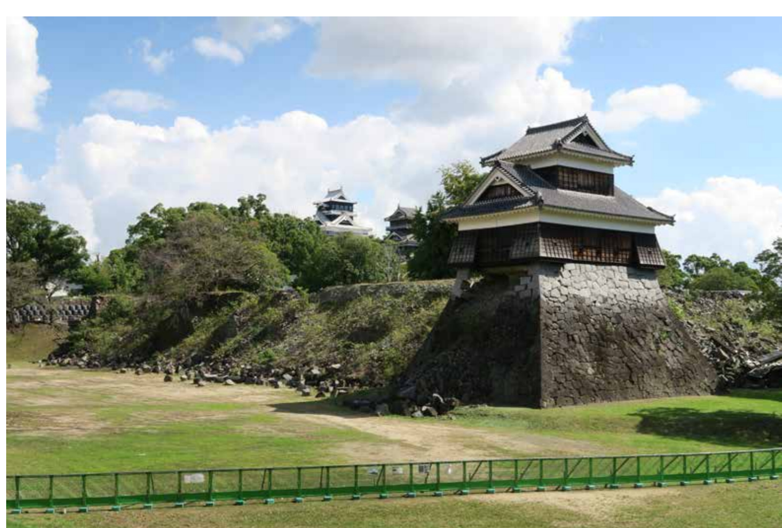
写真2 戌亥櫓と崩落したままの石垣(20181007)
