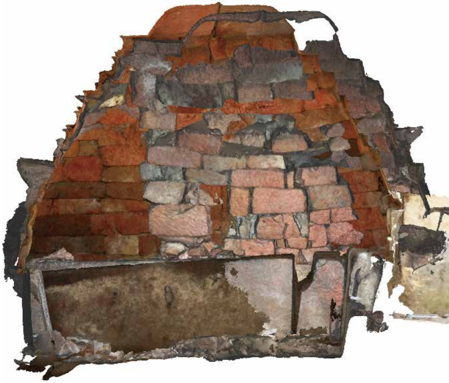
写真9 被災した井寺古墳石室の南側壁(嘉島町作成)
